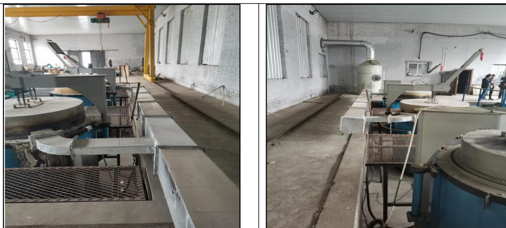
废气收集管路及配套治理设施
